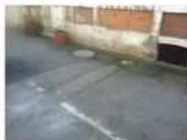
Des tranchées et des réfections à quelques centimètres l'une de l'autre
